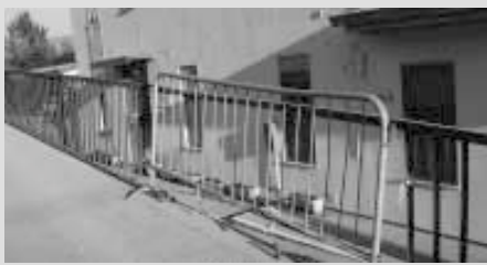
Nella foto, il tratto di ringhiera demolita di fronte all'asilo e non ancora ripristinata dopo 3 mesi dall'incidente.
